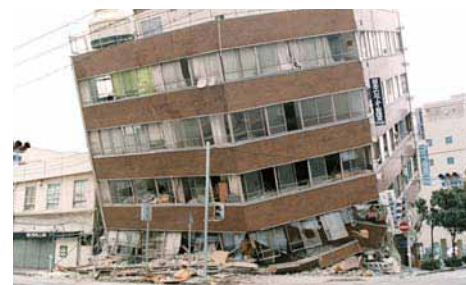
兵庫県南部地震による建物の被害 (写真提供：神戸市)
