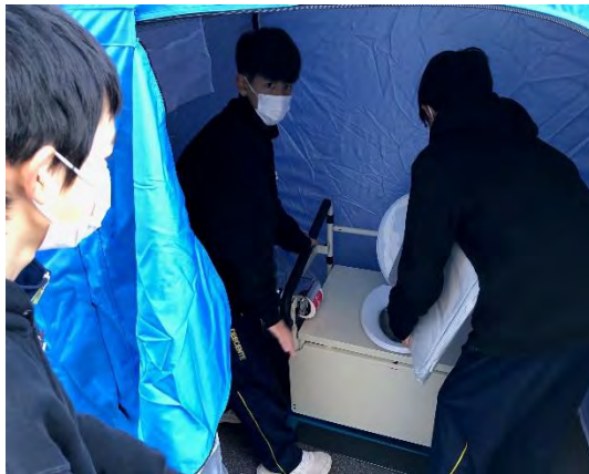
防災トイレの設営
