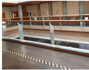
吹き抜け〈転落の危険〉
