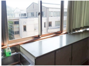
窓〈転落の危険〉
