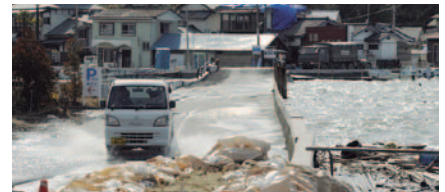
地盤沈下で低くなり、大潮の満潮で冠水した道路を走る車 = 宮城県東松島市 (提供：共同通信社)
