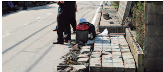
能登半島地震 倒壊したブロック塀=石川県輪島市（平成19年3月26日／提供：一般財団法人 消防科学総合センター）
