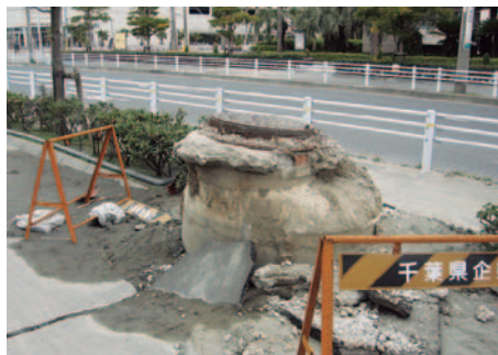
地面の液状化によるマンホールの隆起＝千葉県浦安市(提供:一般財団法人消防科学総合センター)
