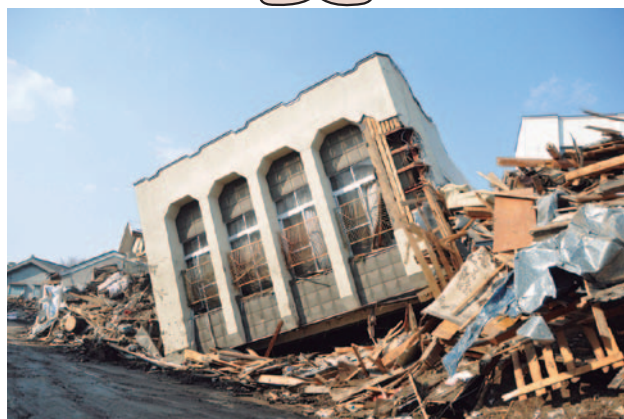
岩手県野田村の被害 (提供: 岩手県建設協会)
