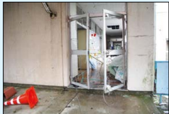
施錠されていた扉
