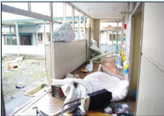
廊下に散乱した保健室のベッドや備品
