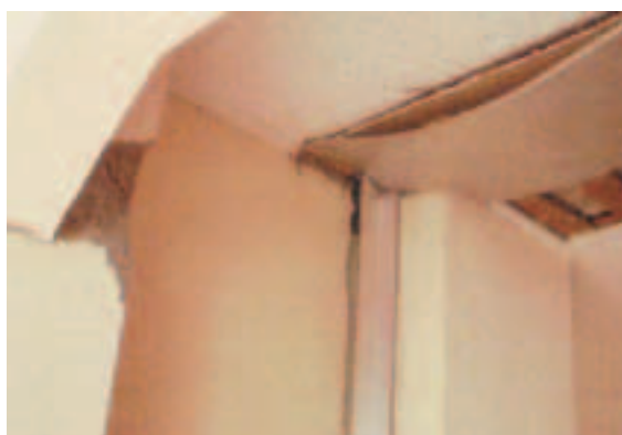
八戸市立白銀中学校（天井破損）
