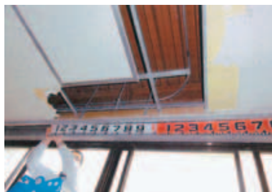
八戸市立東中学校（柔剣道場 天井材破損）
