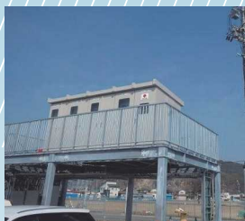
屋外キュービクルのかさ上げ
