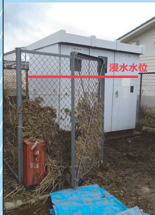
受変電設備(キュービクル)浸水
