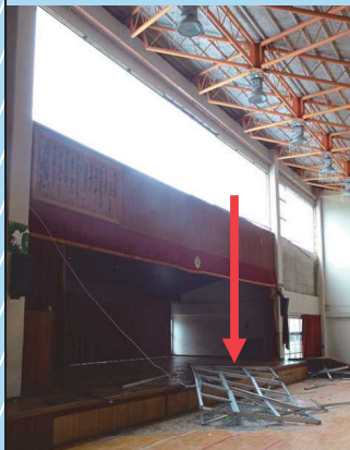
屋内運動場横連窓の脱落
