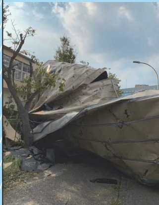
屋内運動場の屋根ふき材脱落
