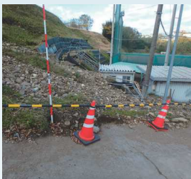
土砂崩れに対する立入禁止措置
