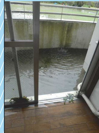
バルコニーからの浸水
