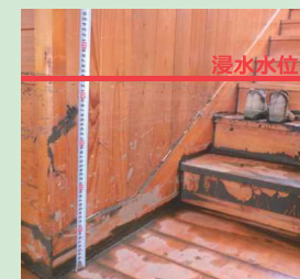
浸水水位の計測
