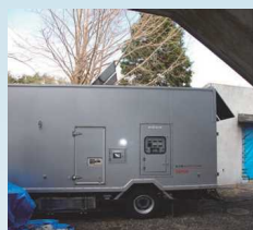
電源車の配備
