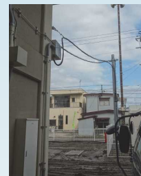
高圧受変電設備が利用できないため、校外の電線より低圧電力を引き込み、仮設電源として利用
