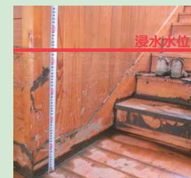
浸水水位の計測
