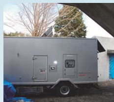
電源車の配備
