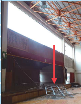
屋内運動場横連窓の脱落
