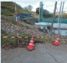
土砂崩れに対する立入禁止措置
