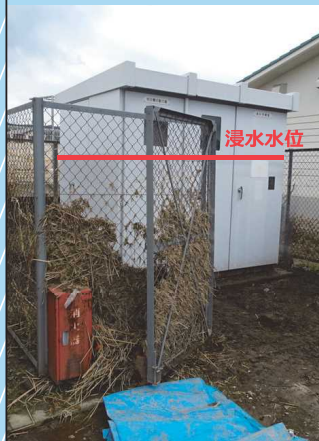
受変電設備(キュービクル)浸水
