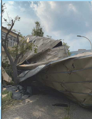
屋内運動場の屋根ふき材脱落
