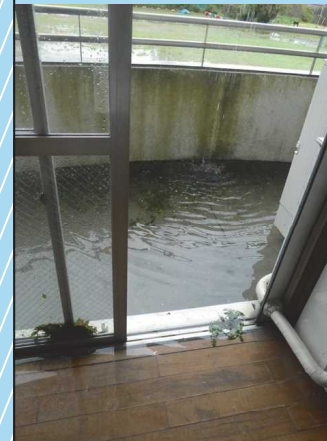
バルコニーからの浸水
