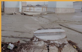
液状化によるマンホールの浮上 (平成7年(1995年)兵庫県南部地震) (埼玉大学 谷川 尚氏提供)
