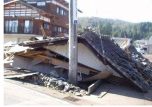
木造住宅の倒壊(平成16年(2004年)新潟県中越地震) (新潟県提供)
