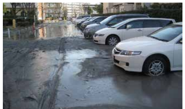
▲液状化：東日本大震災／平成23年(2011年) *写真提供：千葉県浦安市富岡エステート住宅管理組合自主防災隊
