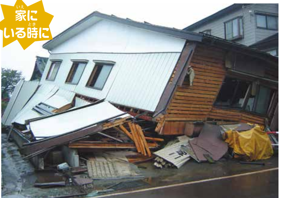
▲1階がつぶれてしまった住宅：新潟県中越地震／平成16年（2004年） * 写真提供：首都大学東京
