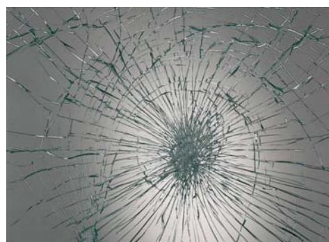
合わせガラスの割れ方 提供) 板硝子協会
