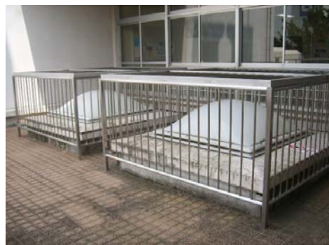
周囲に防護柵が設置された天窓
