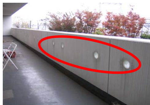
足掛りを排除したバルコニー (児童が穴に足をかけるおそれがあったため、ガラスをはめこんでいる)
