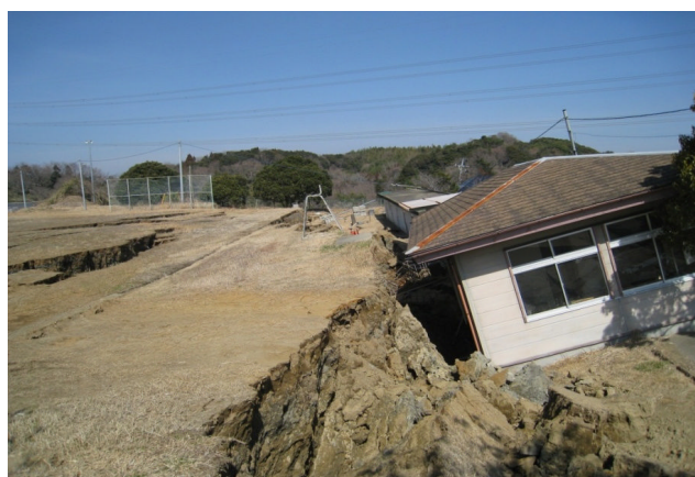
グラウンドの地割れ
