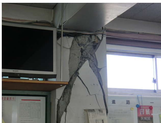
教室の柱の破損
